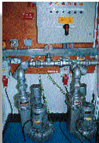
Duty/standby blower layout in GRP kiosk.
